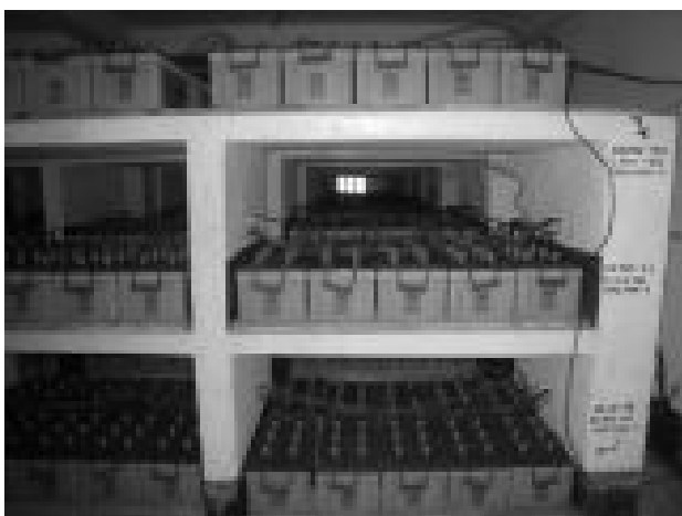
図6 バッテリー倉庫（200VAh × 1000 個）
