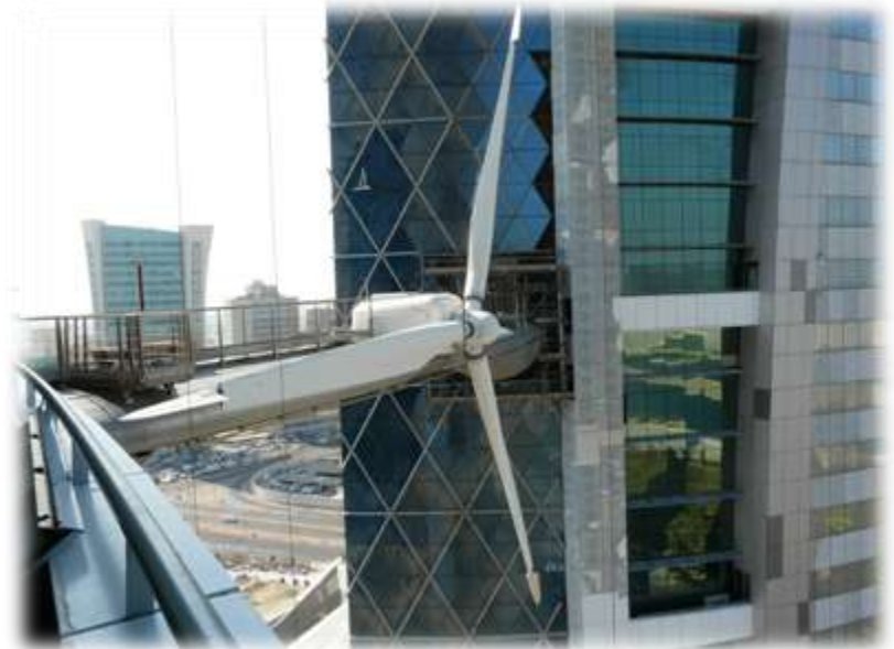
16階コリドールの風車 (225kW)
